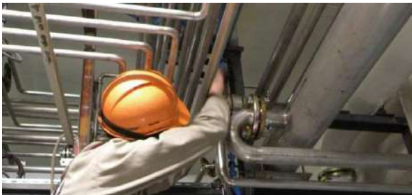
Intervention sur une tuyauterie : travail en hauteur en position bras tendus en l'air
