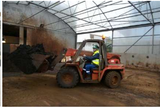
Manutention de boues / compost
